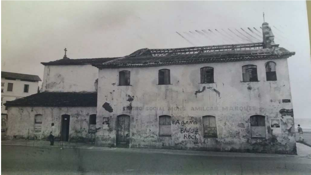
Figura 1 – Pixo na Igreja de Santana na década de 70, visivelmente abandonada e degradada
