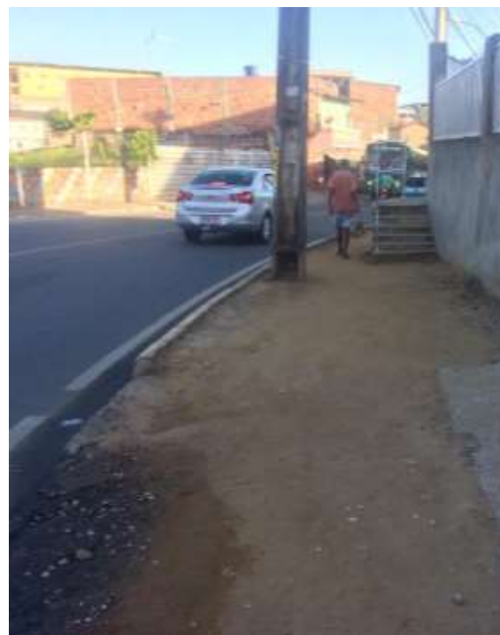
Figura 31: calçada sem pavimentação
