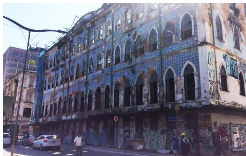
Figura 46 – O conhecido “Casarão de Azulejos Azuis” ainda espera por sua recuperação.
