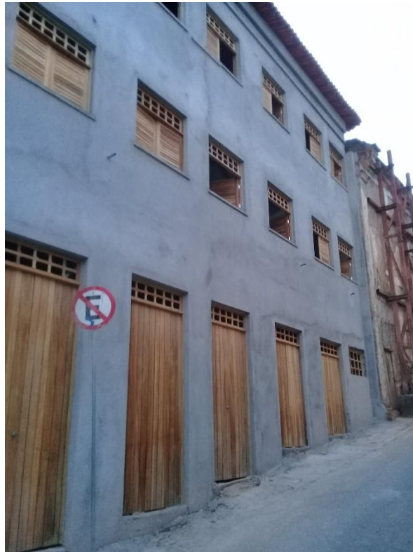
Figura 10. Obras em andamento no imóvel na esquina da rua Guedes de Brito com a São Francisco n°s 15 e 16
