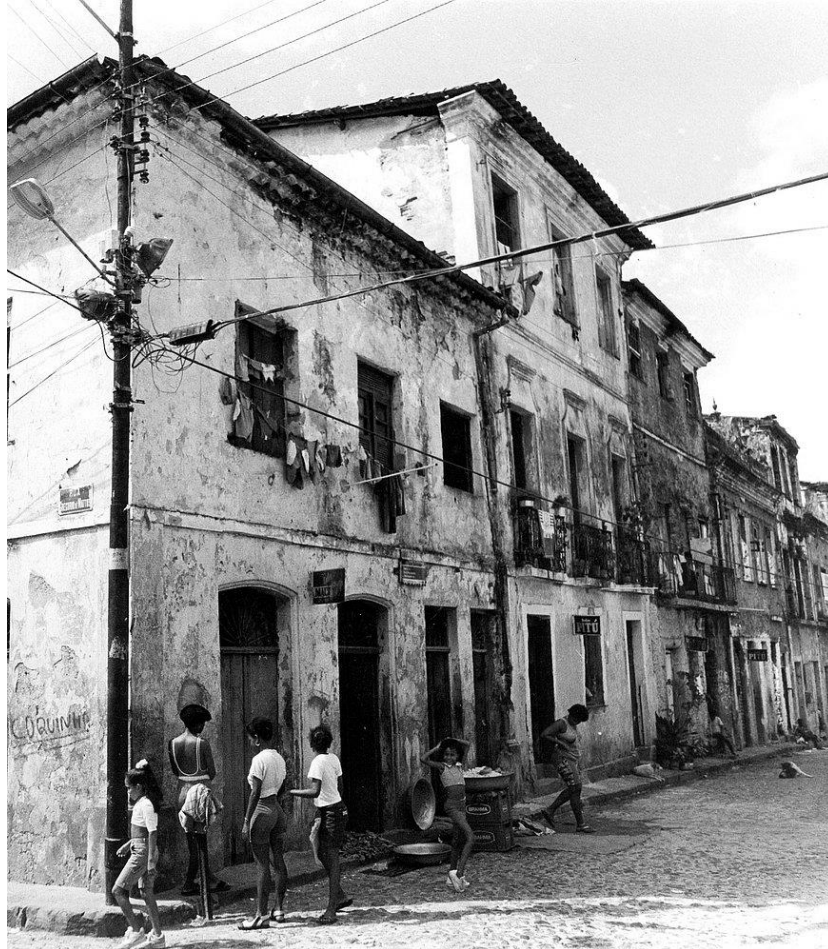
Figura 2. Deterioração física do CHS
