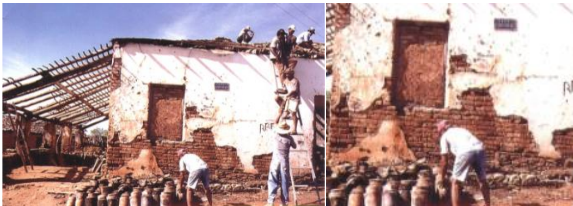
Figura 21 – Casa da fazenda Santo Inácio – demolição da cobertura em carnaúba e telhas artesanais de barro cozido
