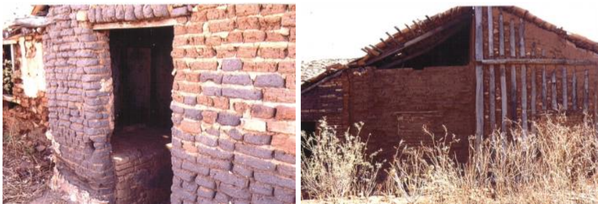
Figura 22 – Vistas externas da casa da fazenda Santo Inácio; oitão em taipa de sopapo com armação em carnaúba
